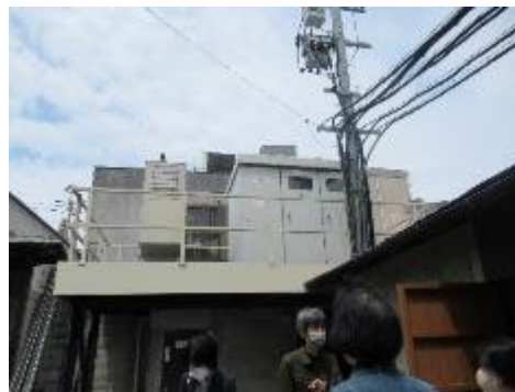
変電設備現状
