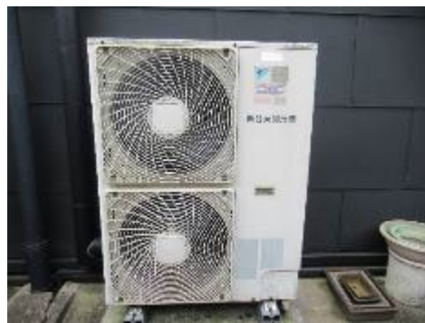
舞台東側系統室外機現状
