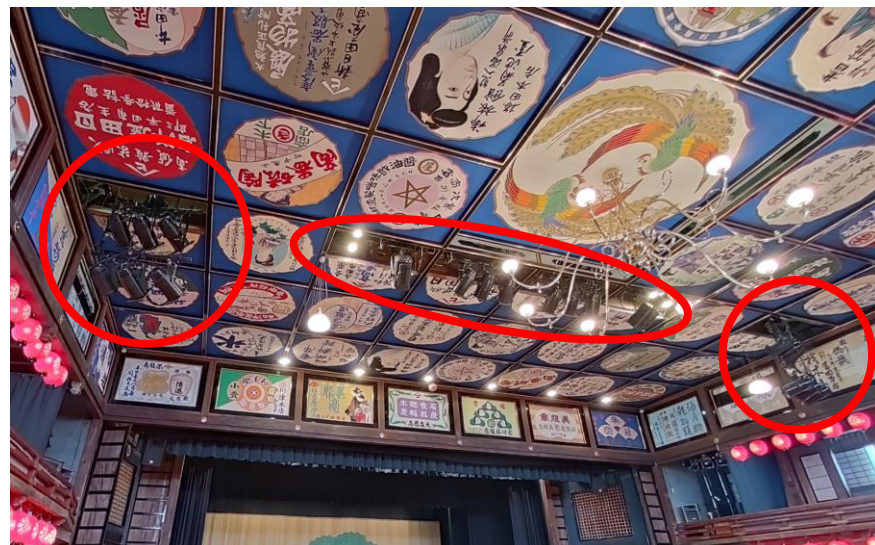
客席エリアの照明設備
