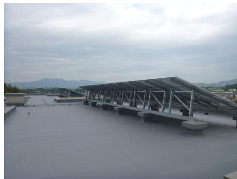
小中一貫校幸袋校に設置された太陽光発電設備
