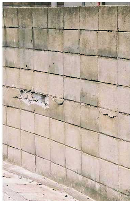
横筋が腐食・体積膨張し、ブロックを損傷している危険な塀
