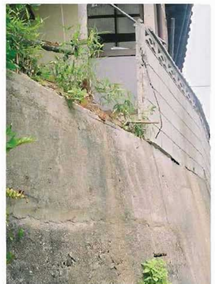
下部の擁壁と一体となるよう施工されず、落下したブロック塀
