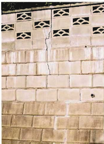
擁壁が損傷を受けると、直上のブロック塀も損傷し危険な状態となる
