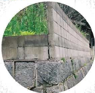
擁壁上のブロック塀 の危険性
